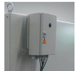
Klemmen-/Schaltkasten Terminal-/switch box
