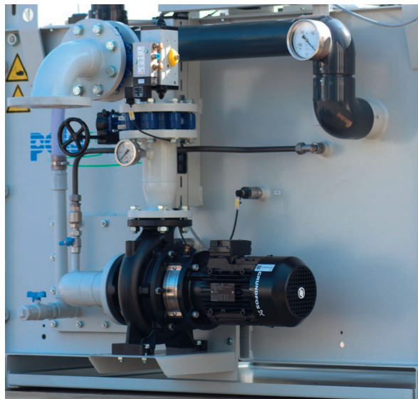
Bomba de descarga / Discharge pump
